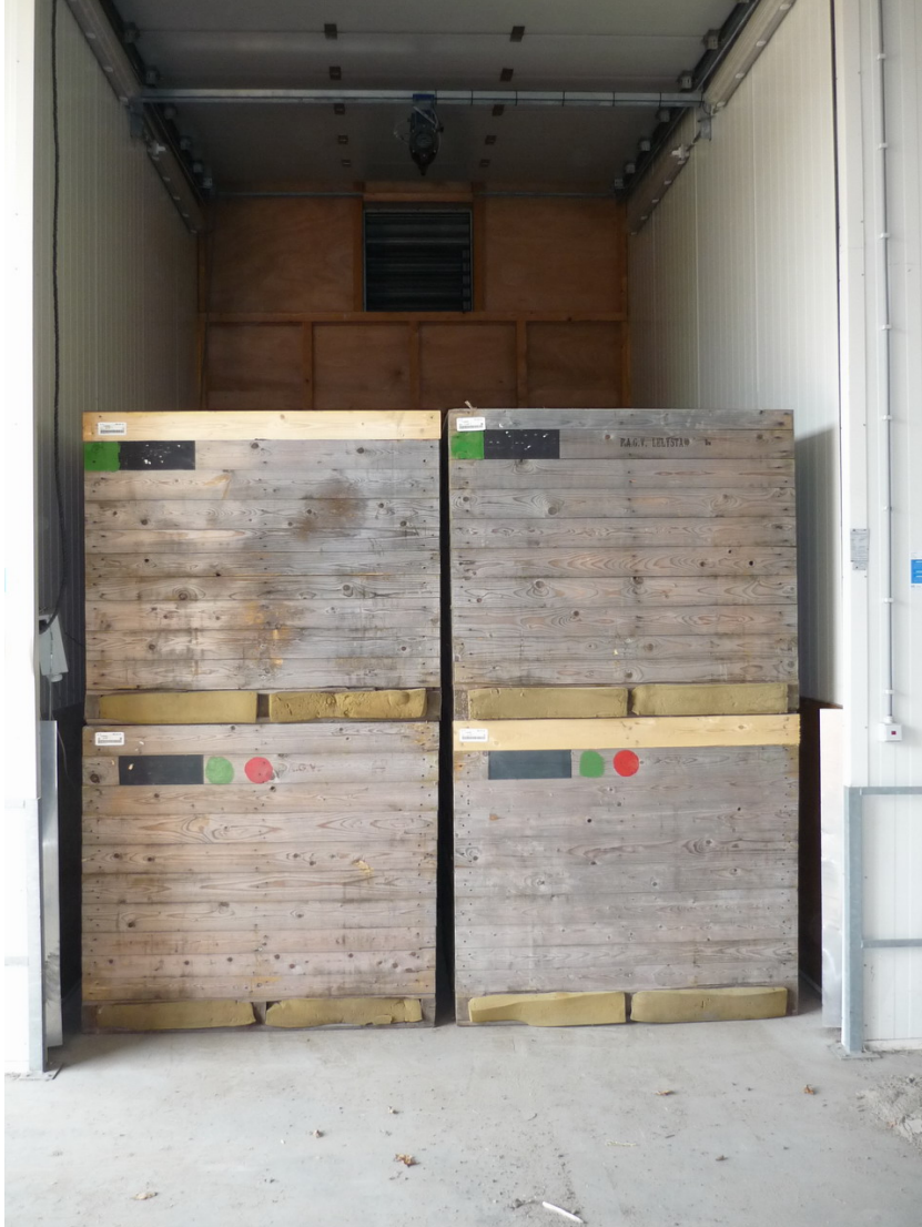
Figuur 5: Dichte kisten waarbij de lucht via de sleuven in de drukwand door de kisten wordt geblazen en vervolgens bovenlangs weer via het zichtbare gat naar de horizontaal geplaatste ventilator boven de drukkamer wordt gezogen. De onderkant van de kisten is dicht, de laag 12 cm erboven bestaat uit latten van 12 cm breed met 2 cm kieren tussen de latten.
