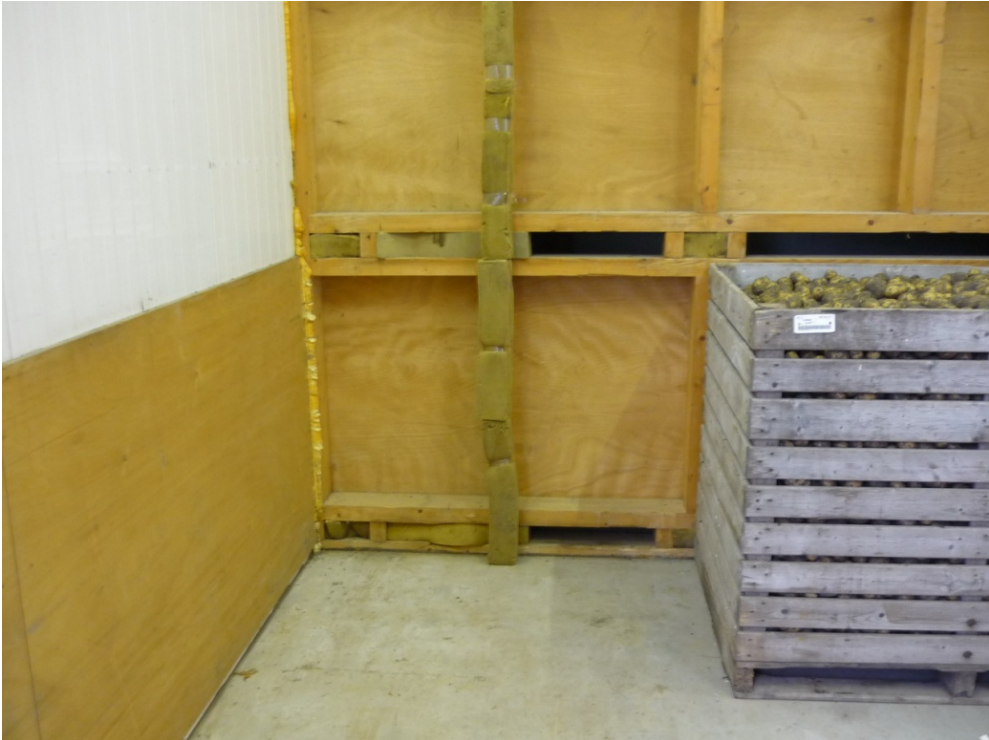
Figuur 3. Dichtmaken gaten in de drukwand voor het zuigen. De kist moet nog 10 cm om zodat de lucht vanuit de ruimte tussen de 2 rijen kisten weggezogen kan worden naar de 4 gaten in de drukwand. De kisten stonden niet strak tegen de drukwand. De schuimbanden voorkomen dat valse lucht wordt aangezogen.
